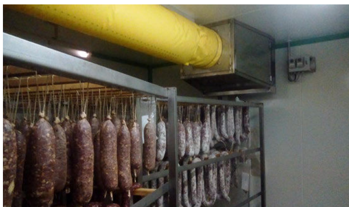
Séchoir fermier avec gaine de répartition
