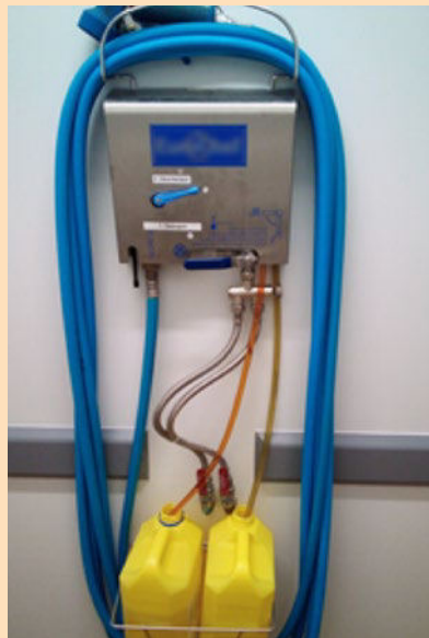
Exemple de centrale de nettoyage
