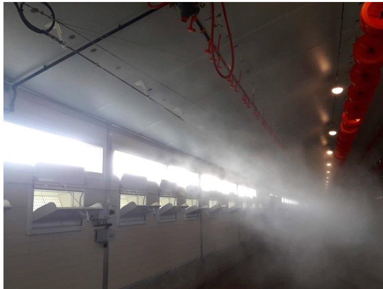
Figure : brumisation en bâtiment avicole (source : CAPDL)
