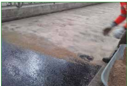
Photo 14 : Au fur et à mesure du coulage, épandage immédiat de sable manuellement en surface. L'objectif est que le sable intègre le bitume en surface encore chaud
