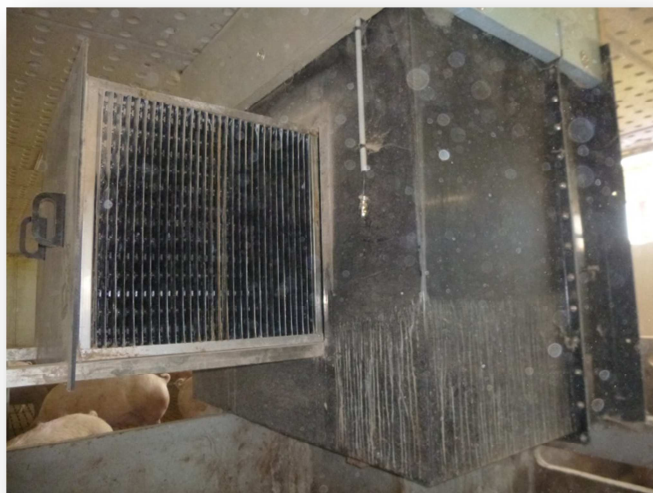
Échangeur adapté sur le système d'aération déjà existant
