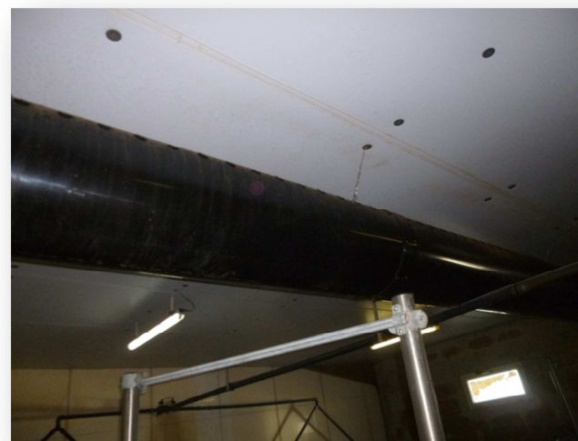
Arrivée d'air par une gaine reliée à la ventilation centralisée
