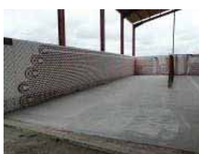
Bâtiment de stockage et son réseau de récupération de la chaleur issue des produits organiques
