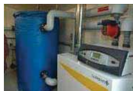
Chaufferie (chaudière gaz à condensation, cuve tampon, compteur...)
