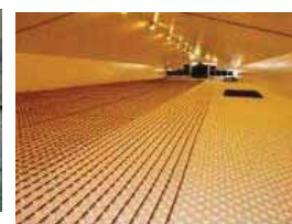
Bâtiment avicole avec plancher chauffant et régulation centralisée de l'ambiance
